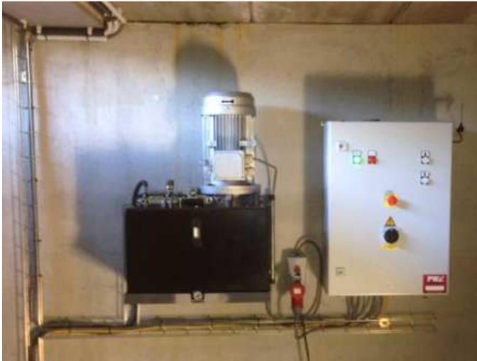
Hydraulische groep + Sturingskast met bediening
